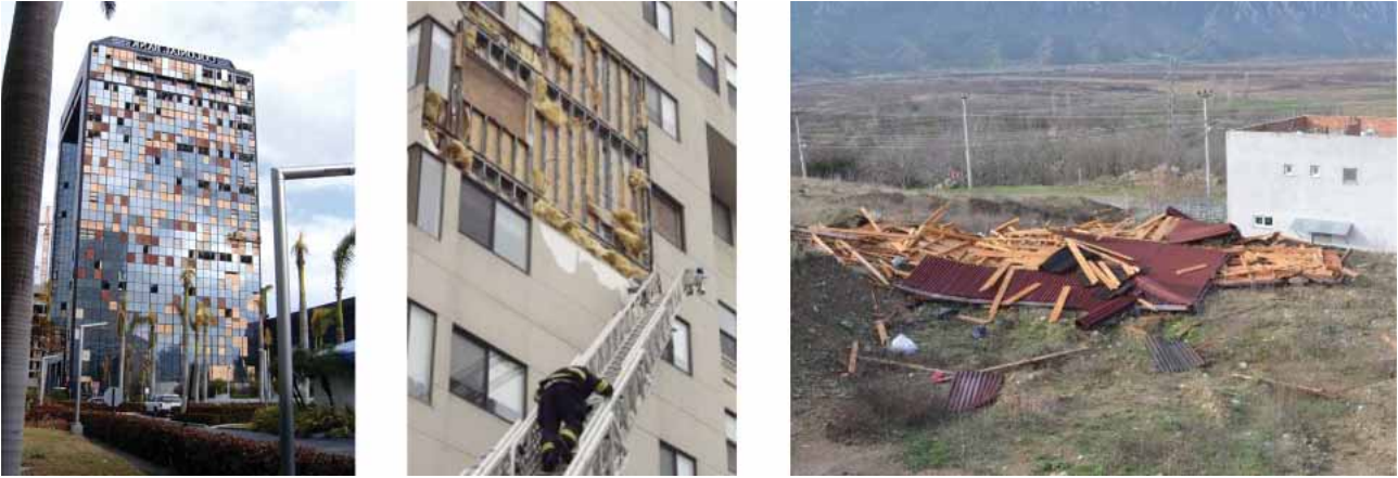
Şekil 2.1. Rüzgâr kaynaklı cephe ve çatı hasarlarından örnekler [29], [30] ve [31]
