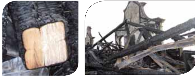
Şekil 3.6. Haydarpaşa Garı çatı yangını sonrası durum.
